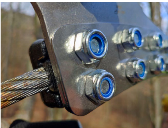
Montaggio vite non conforme
